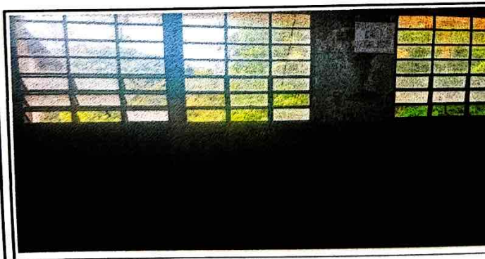
Foto 5: Se observa las ventanas a cambiar
