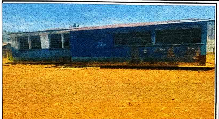
Foto 2: Se observa el deterioro de la pintura de las aulas
