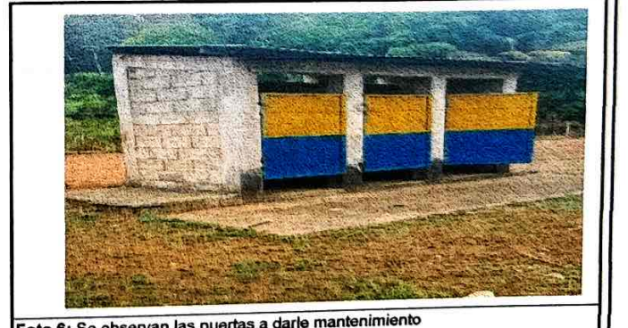
Foto 6: Se observan las puertas a darle mantenimiento
