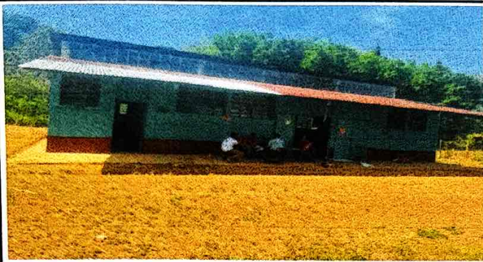
Foto 1: Se observa el deterioro de las laminas de las aulas
