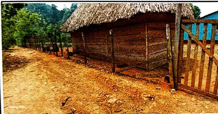
Foto 3: Se observa la circulación del predio de la escuela en estado deteriorado
